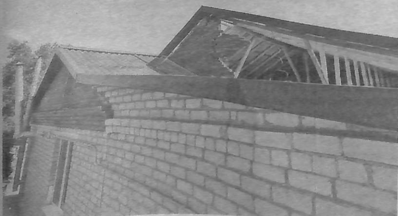
Повреждена кровля дома.
