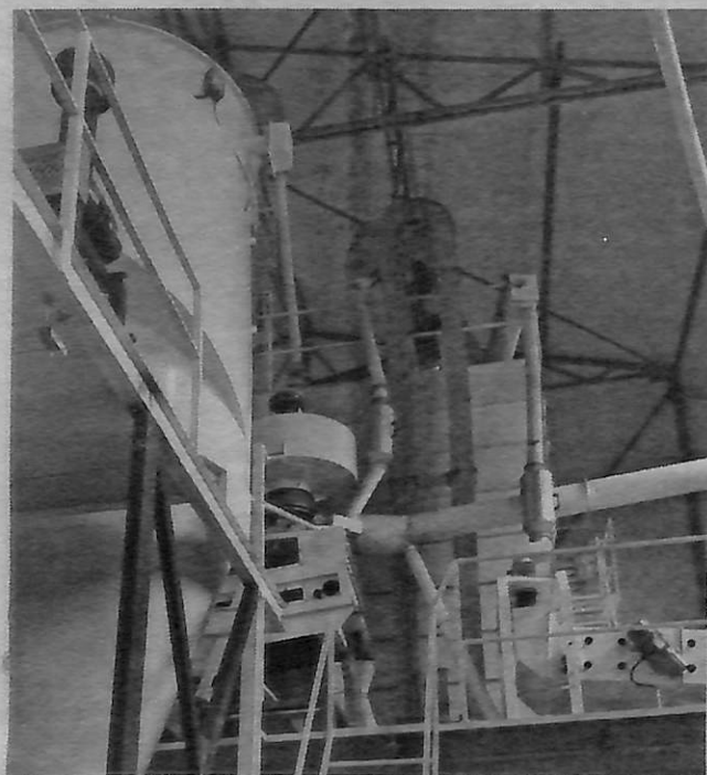
Оборудование мельницы ИП главы КФХ Г.А.Оганесян.
