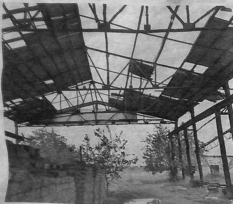
Последствия стихии на здании кирпичного завода.
